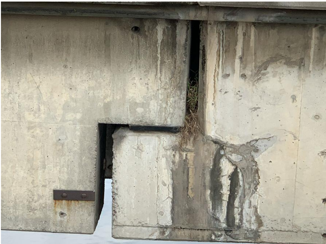
Ilustración 44 – Estado de DAP END en puente sobre el río Chamelecón
