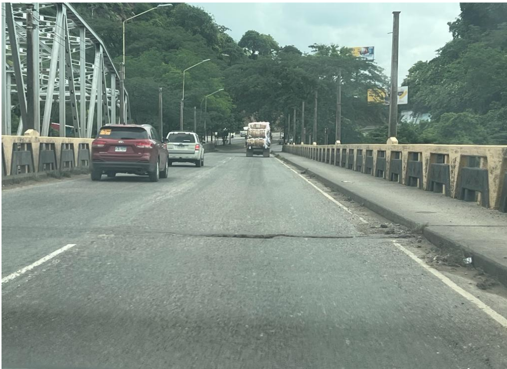
Anexo 2 - Daños en losas de aproximación
