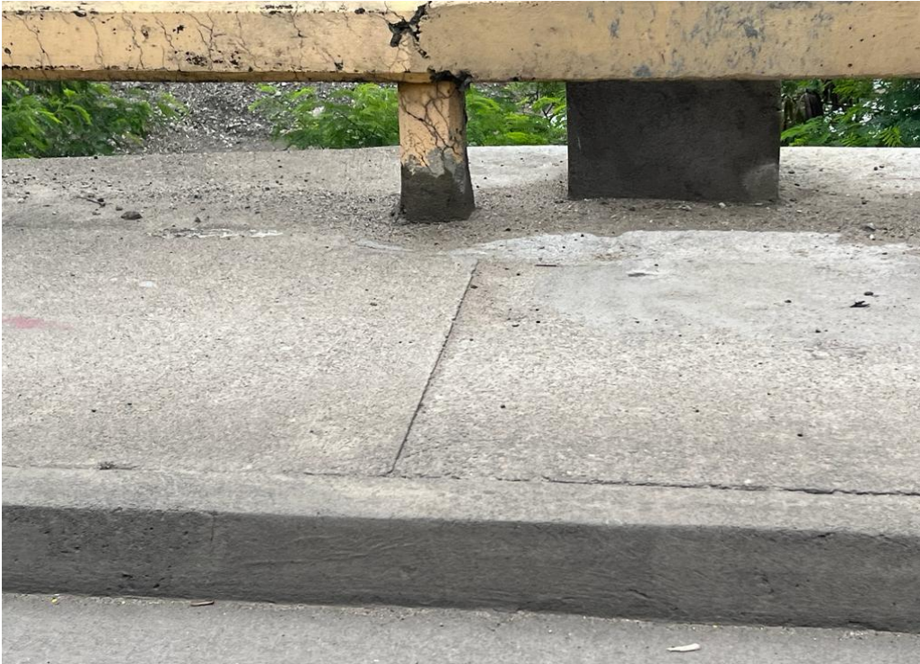
Anexo 1 - Daños en pretilas
