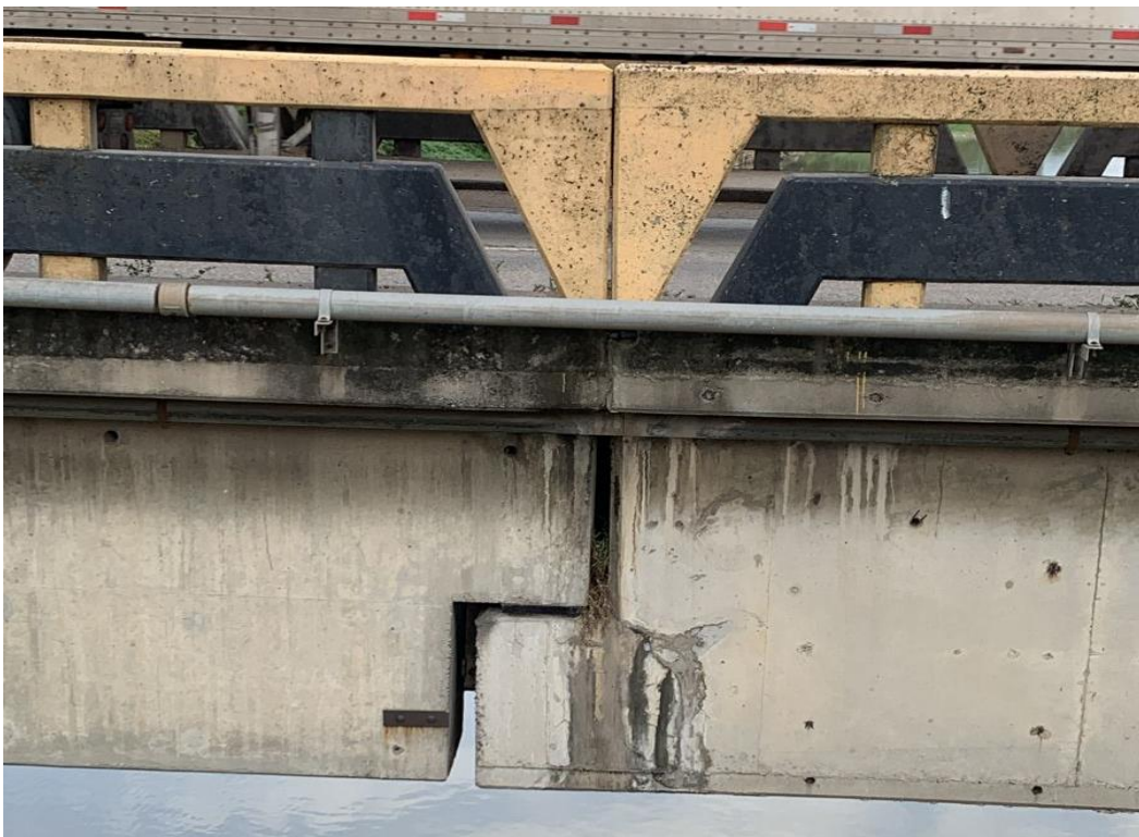
Ilustración 45 – Materia orgánica y fractura en DAP END de puente sobre el río Chamelecón
