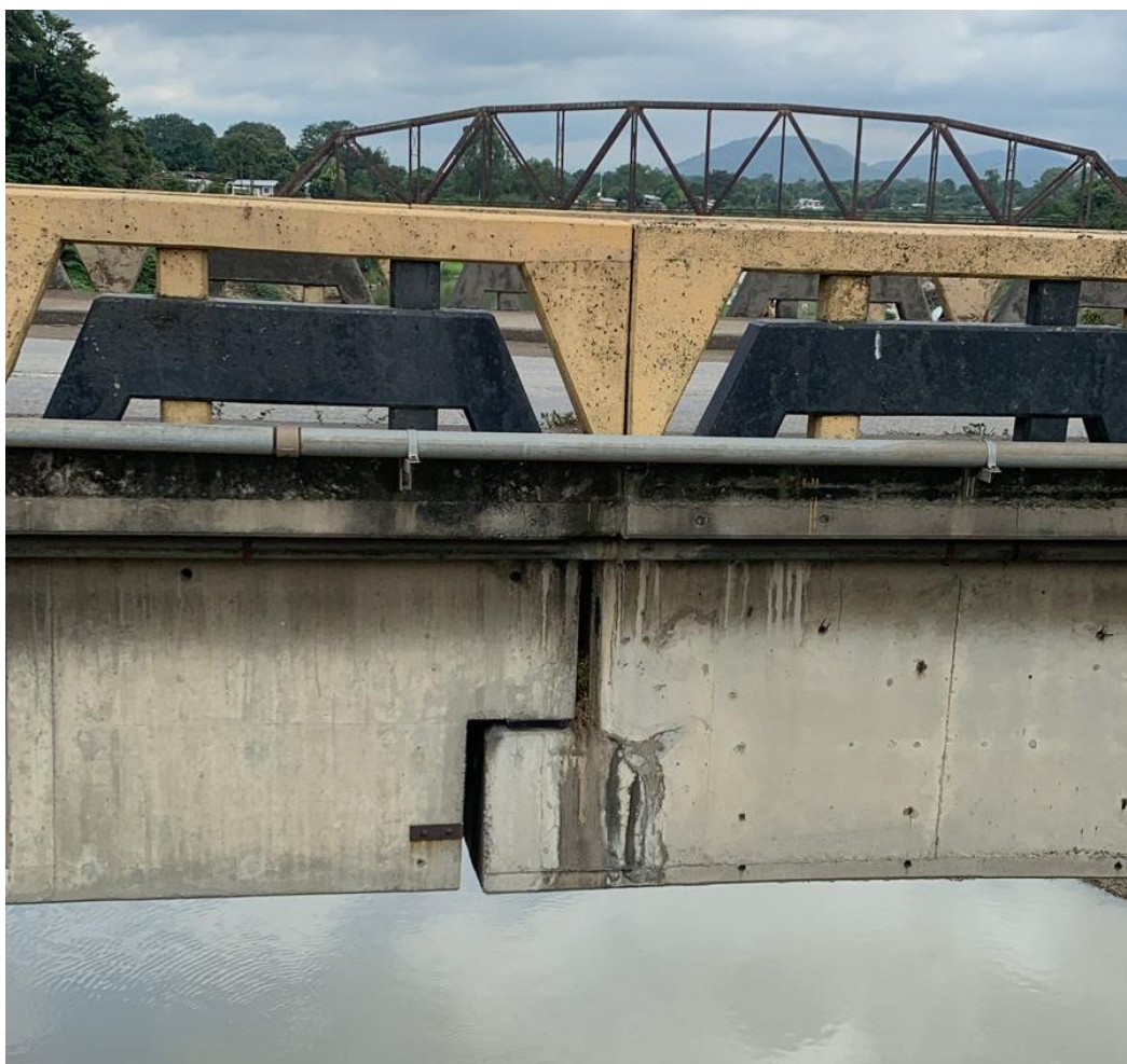
Anexo 6 - Daños en DAP END puente de concreto
