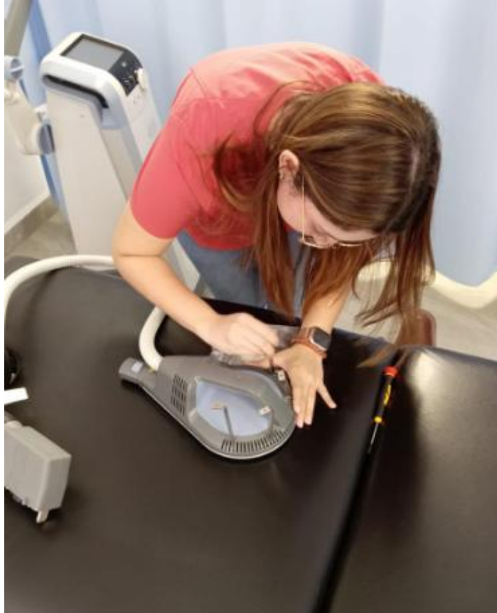
Ilustración 71 Mantenimiento Correctivo SIS
