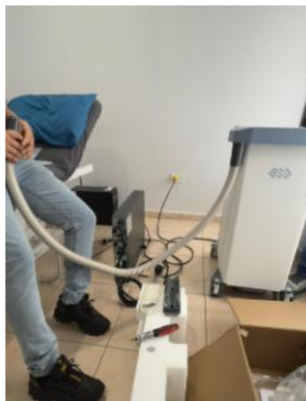
Ilustración 141 Instalación de UPS y crioterapia
