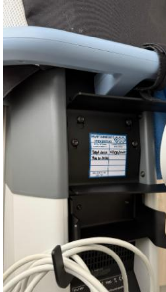
Ilustración 189 Colocación de viñetas de mantenimiento preventivo en EMFACE
