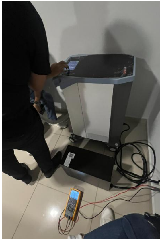
Ilustración 52 Mediciones de voltaje en UPS y toma corrientes
