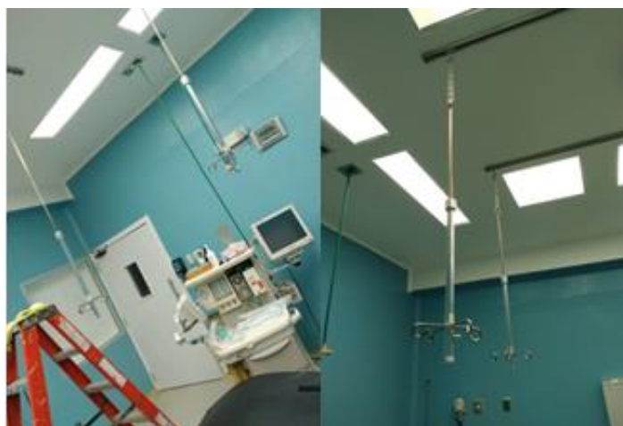
Ilustración 65. Atriles de cielo en sala de operaciones
