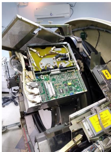
Ilustración 74. Jumpers de la fuente de alta tensión
