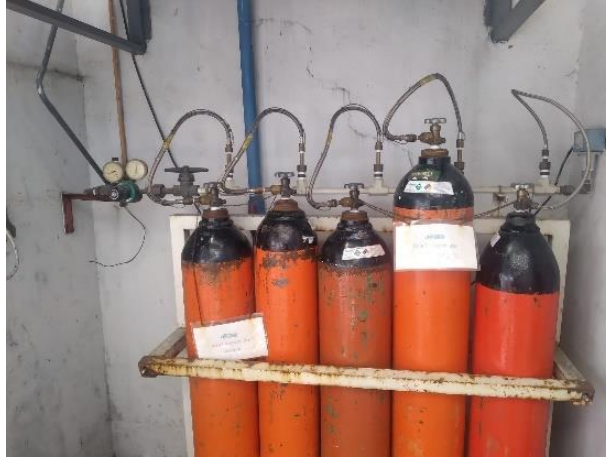
Ilustración 23. Sistema de suministro de aire comprimido de cilindros tipo H
