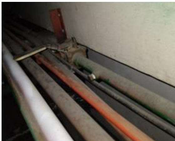
Ilustración 46. Válvula de cierre del suministro de oxígeno
