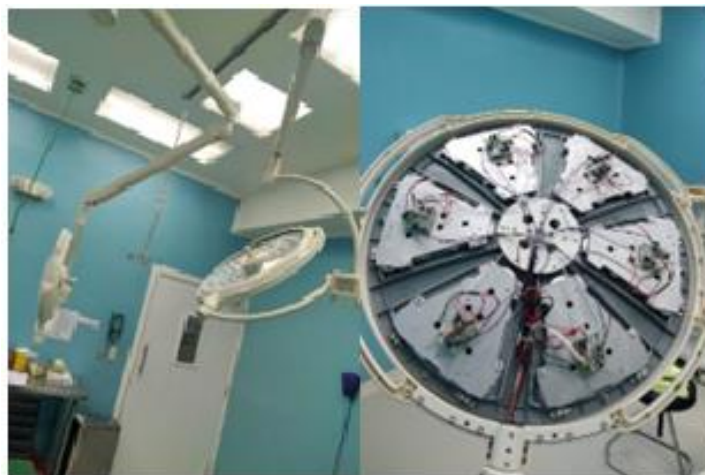
Ilustración 24. Satélite de lámpara cielítica en sala de operaciones
