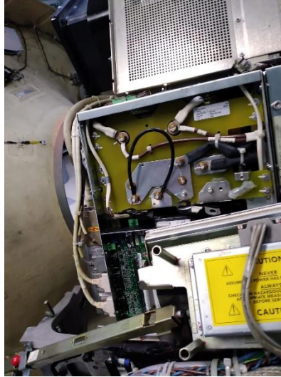
Ilustración 75. Prueba de corto en los jumpers de la fuente de alta tensión
