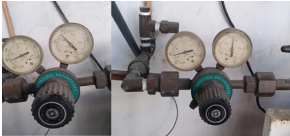
Ilustración 43. Manómetro del sistema de aire comprimido
