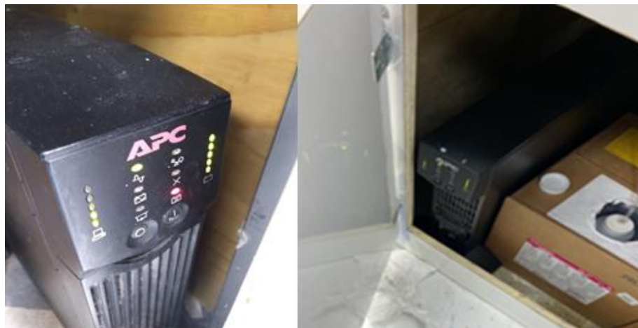
Ilustración 56. Cambio de UPS en analizador de hematología
