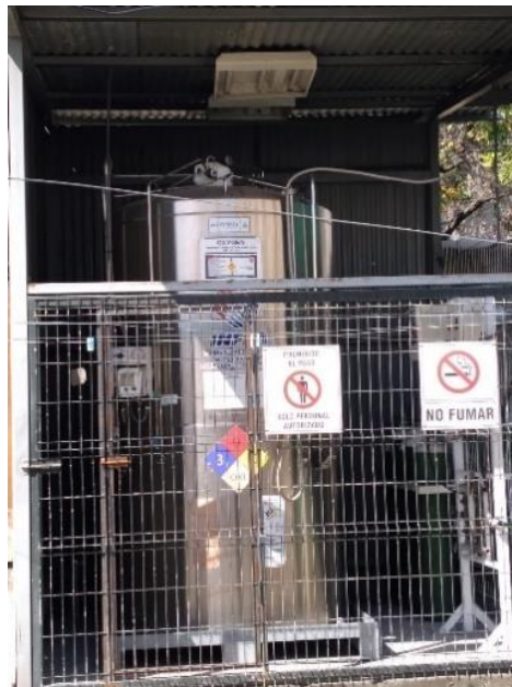
Ilustración 22. Tanque criogénico de oxígeno
