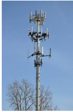
Figura 5. Sitio (Estación Base o Celda)
