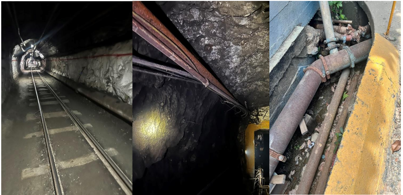
Figura 48. Condiciones actuales de la línea de distribución en mina Trackless y superficie.
