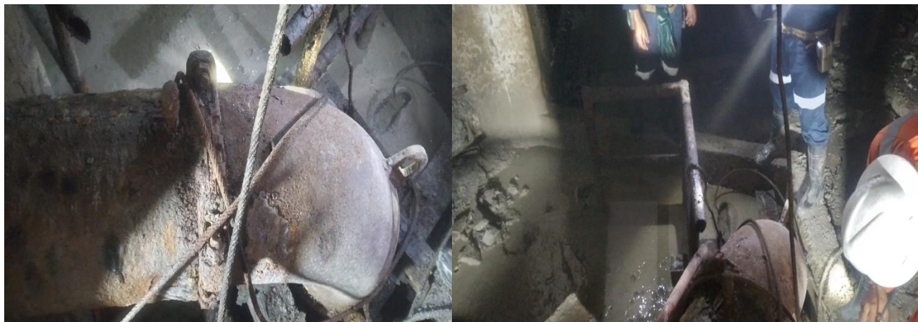
Figura 49. Condiciones actuales de la línea de distribución en mina convencional
