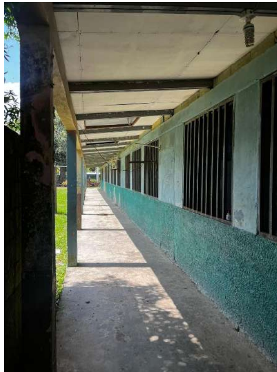
Figura 10. Daños en la Infraestructura Actual de CEP Miguel Paz Barahona
