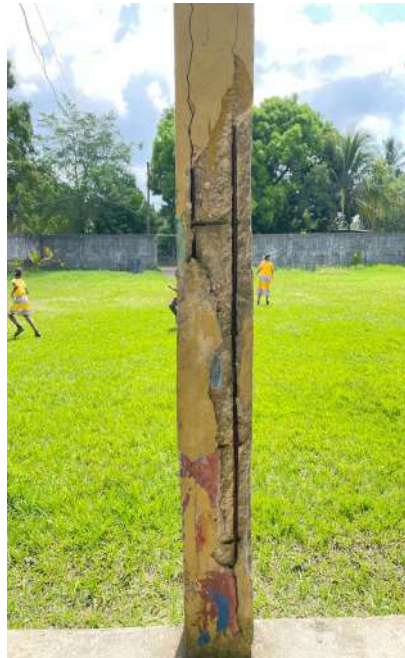
Figura 52. Columna de concreto con varilla expuesta y fisuras verticales.
