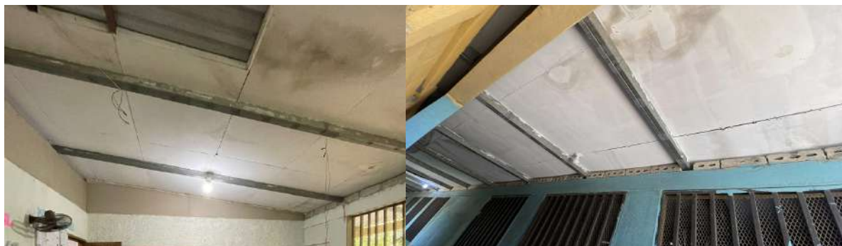
Figura 91. Formación de hongos y moho en cielo raso
