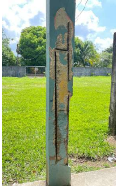
Figura 37. Columna severamente dañada en el Centro Escolar
