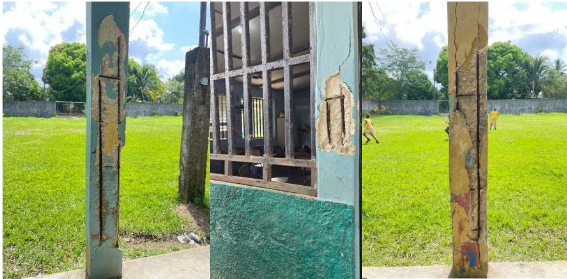
Figura 93. Daños a la infraestructura por motivos naturales
