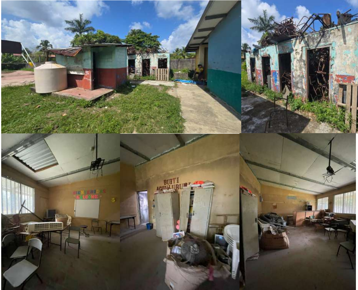
Fuente: Fotografía muestra daños por la falta de mantenimiento en espacios de abandono. Fotografía propia: I. Agüero, C. Piloña (2025)
