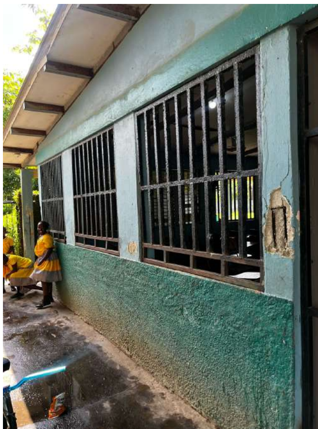
Figura 54. Fachada de aula con desprendimiento de repello y signos de humedad
