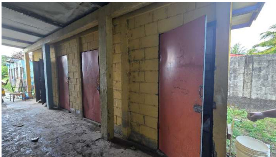
Figura 56. Baños escolares sin señalización ni condiciones sanitarias adecuadas, con acceso limitado al agua.
