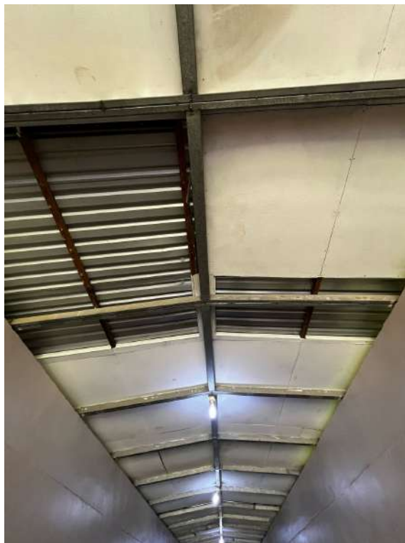
Figura 53. Cubierta del pasillo con deterioro en paneles de cielo falso y estructura metálica expuesta.
