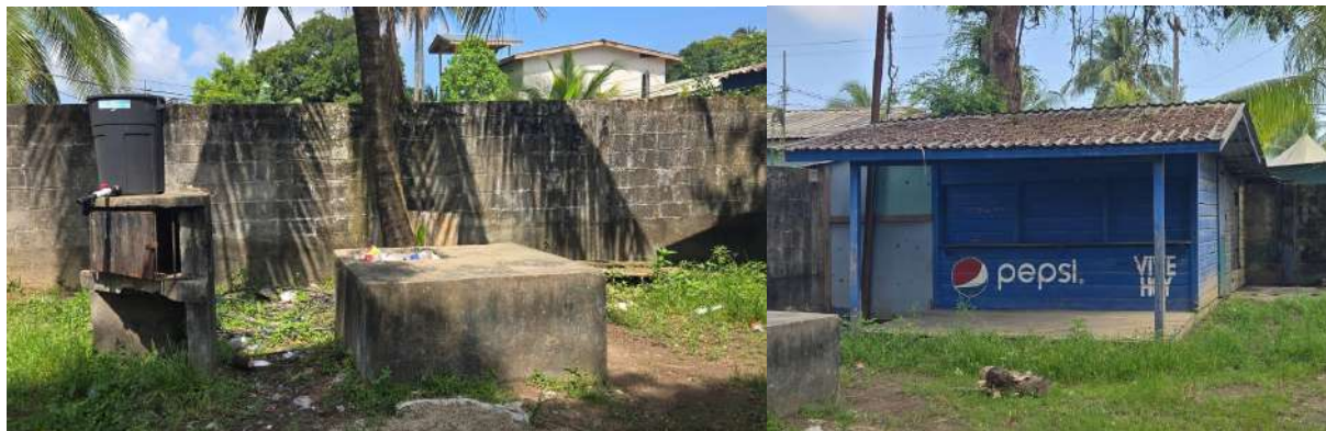
Figura 92. Daños a la infraestructura por falta de mantenimiento
