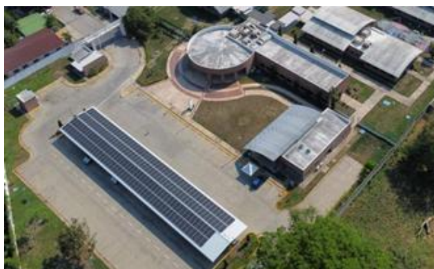
Figura 18 Instalación fotovoltaica en CCM de San Pedro Sula y Choloma
