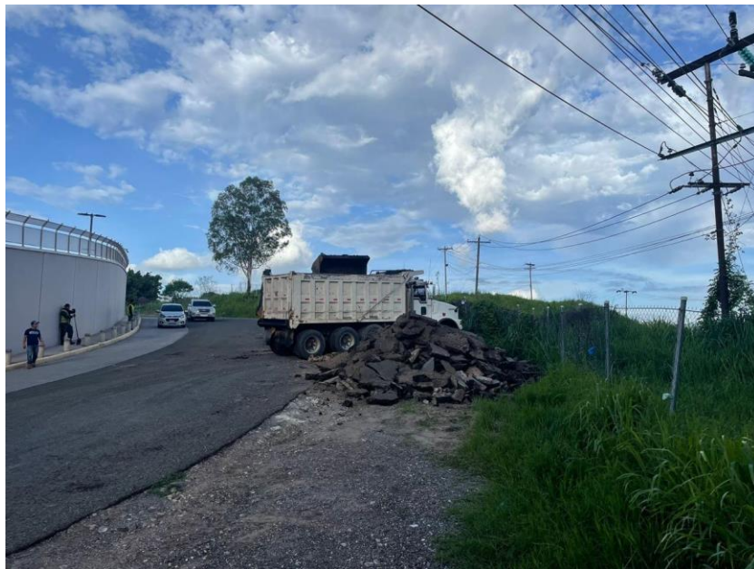
Figura 5: Desperdicio de carpeta asfáltica ubicada en hombro de carretera
