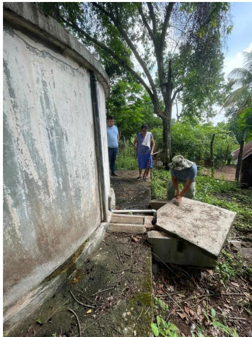
Anexo 4 - Tanque de almacenamiento existente en la comunidad
