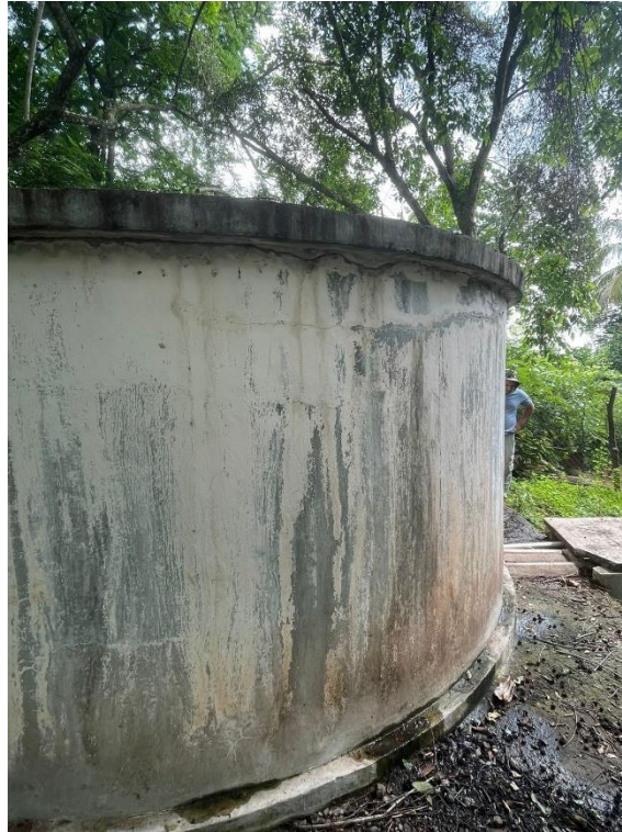
Ilustración 12 - Estado actual de las fisuras del tanque de almacenamiento
