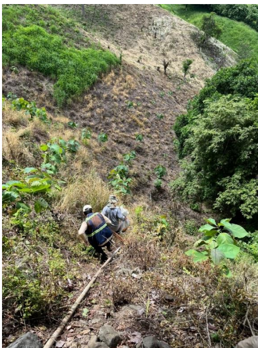
Anexo 2 - Toma de puntos en zonas de pendiente pronunciada durante el levantamiento topográfico de la línea de conducción
