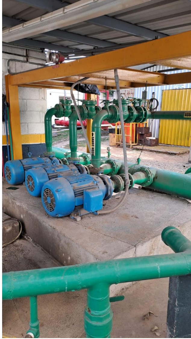
Ilustración 20-Bombas de Agua Dura
