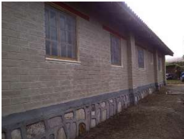
Ilustración 79. Sobre-cimentación de mampostería
