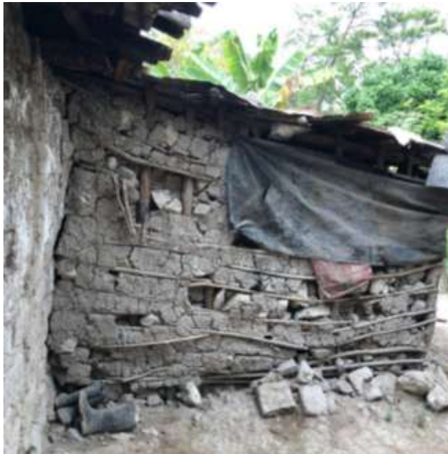
Ilustración 10. Deterioro de pared por inadecuada técnica constructiva
