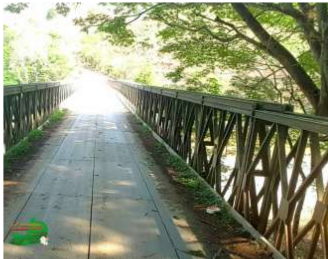
Ilustración 17. Falta de mantenimiento en el puente principal de Ojuera
