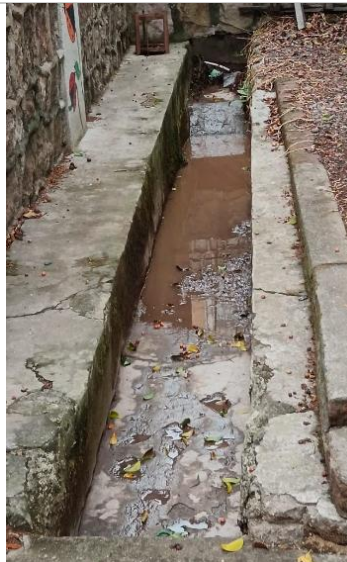
Sistema de drenajes tipo zanja deteriorado y presencia de desechos que obstruyen el sistema.
