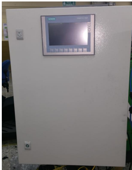
Ilustración 16. Panel original con pantalla HMI
