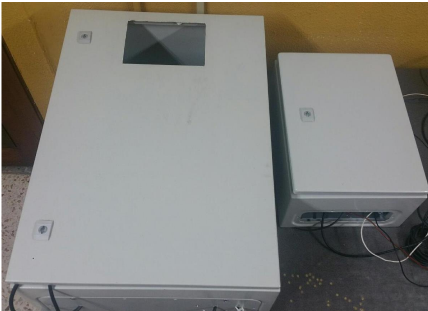
Ilustración 18. Diferencia de tamaño en panel de control eléctrico
