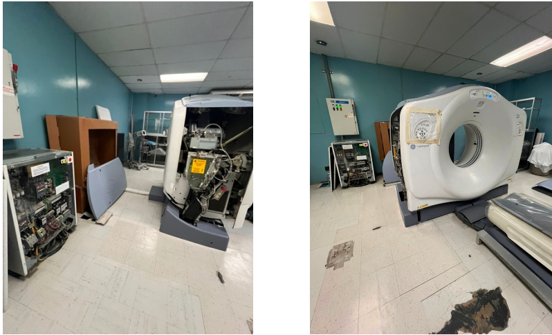
Ilustración 64: Supervisión de HOSPITEC al tomógrafo
