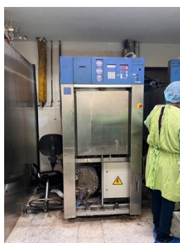
Ilustración 72: Inspección de Autoclave Matachana
