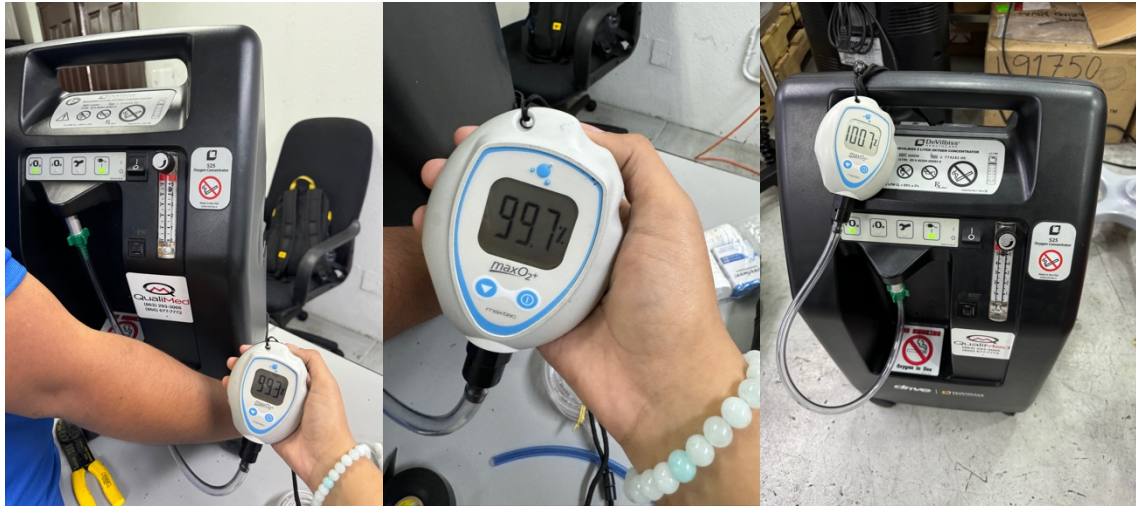
Ilustración 35. Mantenimiento Correctivo Concentrador de Oxígeno - S7
