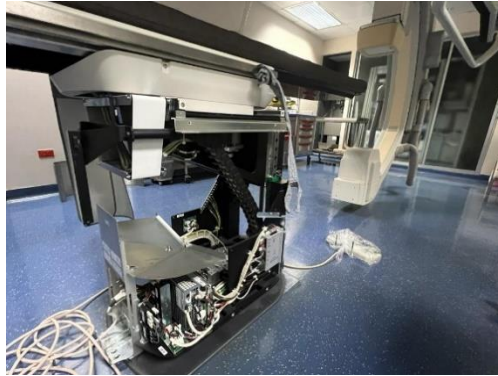
Ilustración 13. Cableado de angiógrafo.
