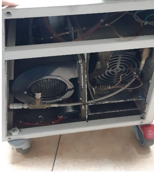
Ilustración 43: Compresor Newport C250 con circuito eléctrico desconectado
