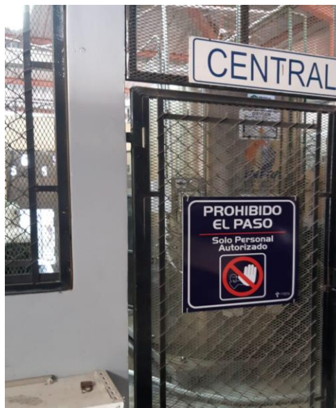
Ilustración 26: Supervisión de la Central de Gases del HDV
