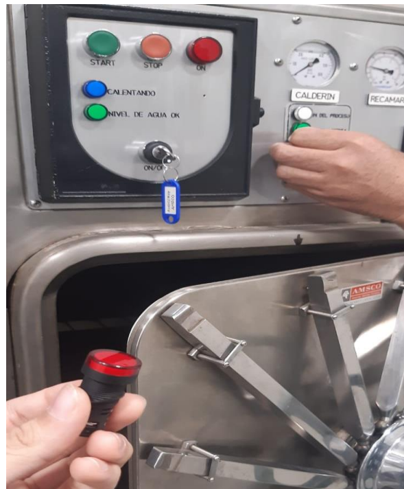
Ilustración 29: Leds de autoclave AMSCO en mal estado
