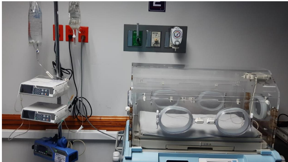
Ilustración 4: Bombas de infusión reinstaladas en sala cuna
