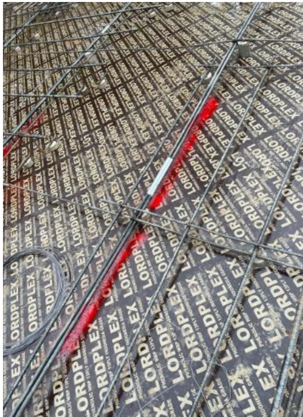
Ilustración 36-Señalización de Cables
