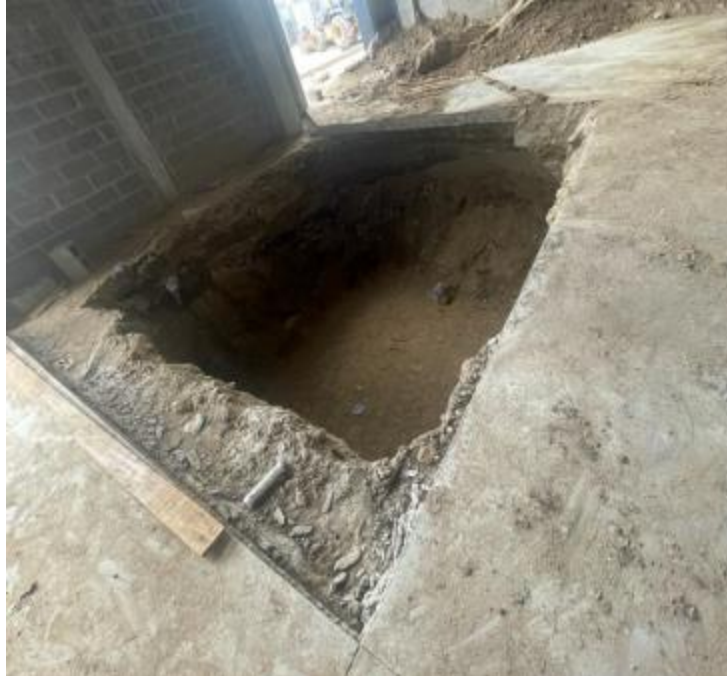
Ilustración 3-Cisterna en Área #1 y #2
