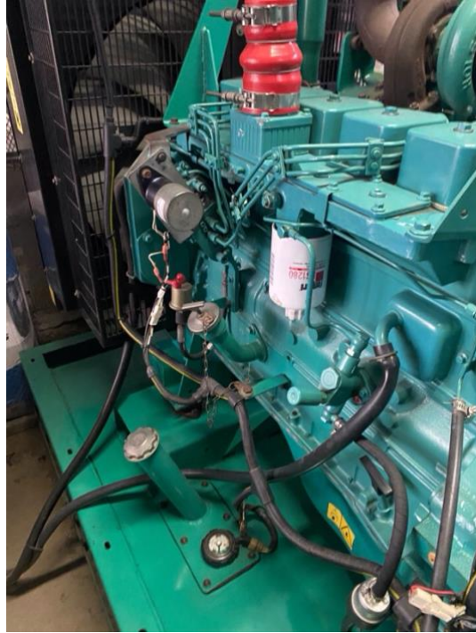
Ilustración 15. Manguera a reemplazar en generador electrico.
