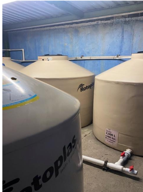
Ilustración 16. Tanques de agua cruda previo a limpieza semanal.
