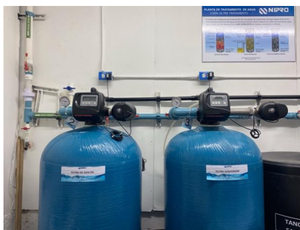
Ilustración 14. Filtros de Zeolita y Suavizador de la Planta de Tratamiento De Agua.
