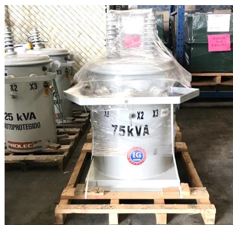
Figura 73 Transformador enfriado por aceite monofásico de 75 KVA, 19800V - 120/240V
