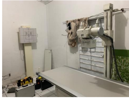
Ilustración 33 Bucky de pared y mesa radiolúcida instalada
