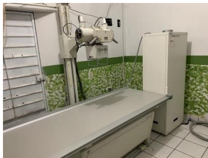
Ilustración 34 Equipo rayos X instalado
