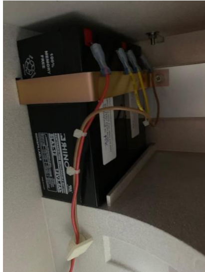
Ilustración 23 Baterías en mal estado
