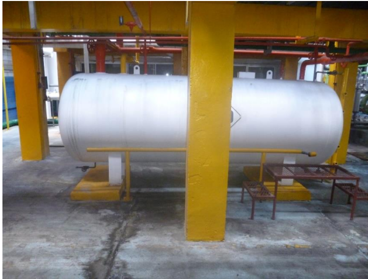
Ilustración 16. Tanque de refrigerante industrial
