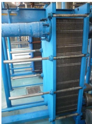
Ilustración 44. Intercambiador de calor EMSULA
