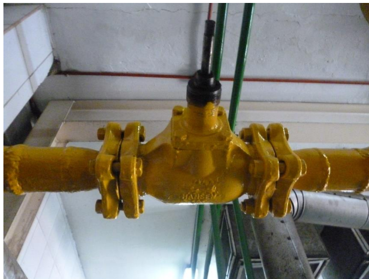
Ilustración 19. Válvula de globo industrial
