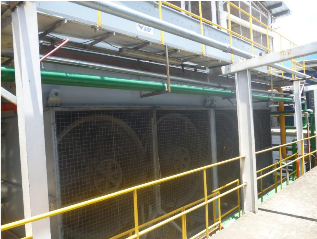
Ilustración 35. Ventiladoras de Condensador #2 EMSULA
