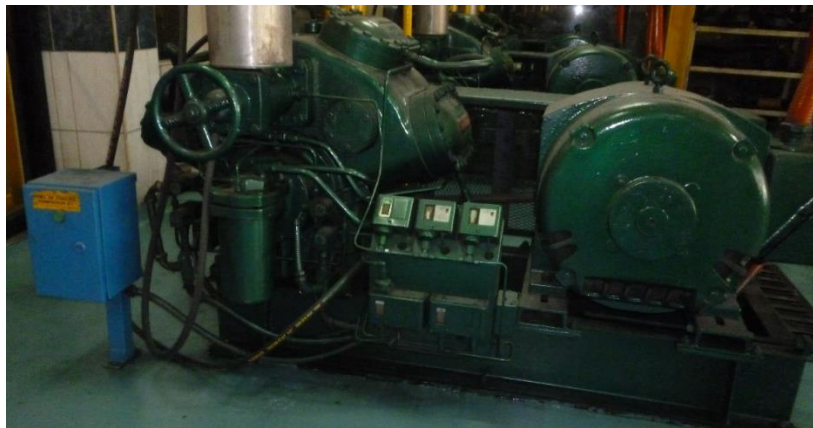
Ilustración 12. Compresor Vilter industrial
