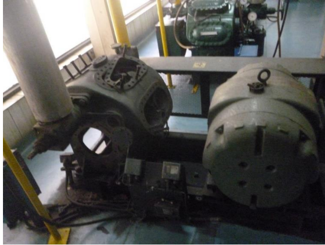
Ilustración 41. Compresor Vilter #1 Desmantelado
