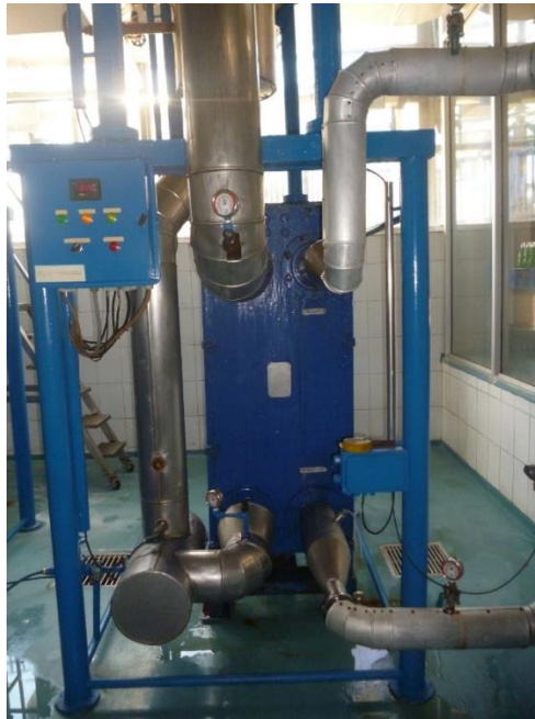
Ilustración 36. Vista lateral intercambiador de calor Línea #1 EMSULA
