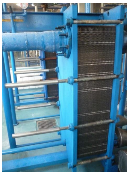
Ilustración 37. Placas intercambiador de calor Línea #1 EMSULA
