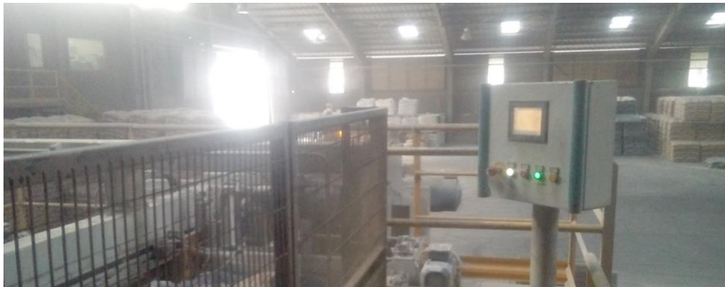
Ilustración 33. Panel de control envasadora 3 POLIMAT C40.
