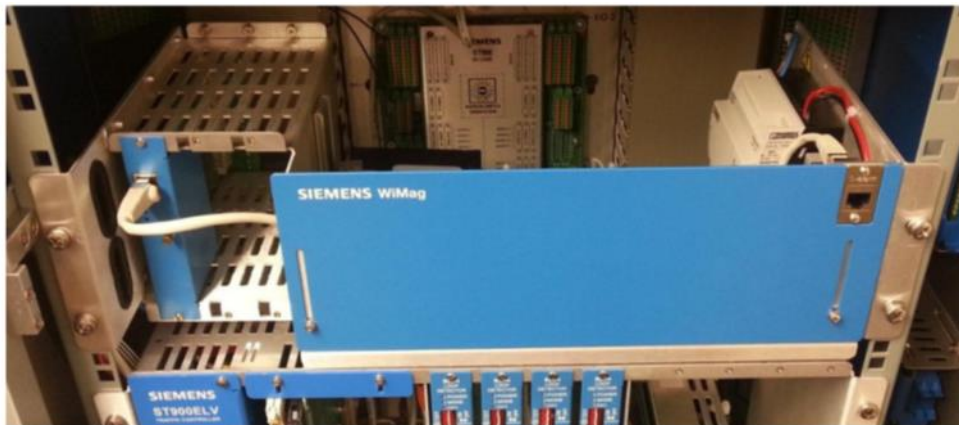
Ilustración 16. Rack Siemens Sitraffic Wimag.
