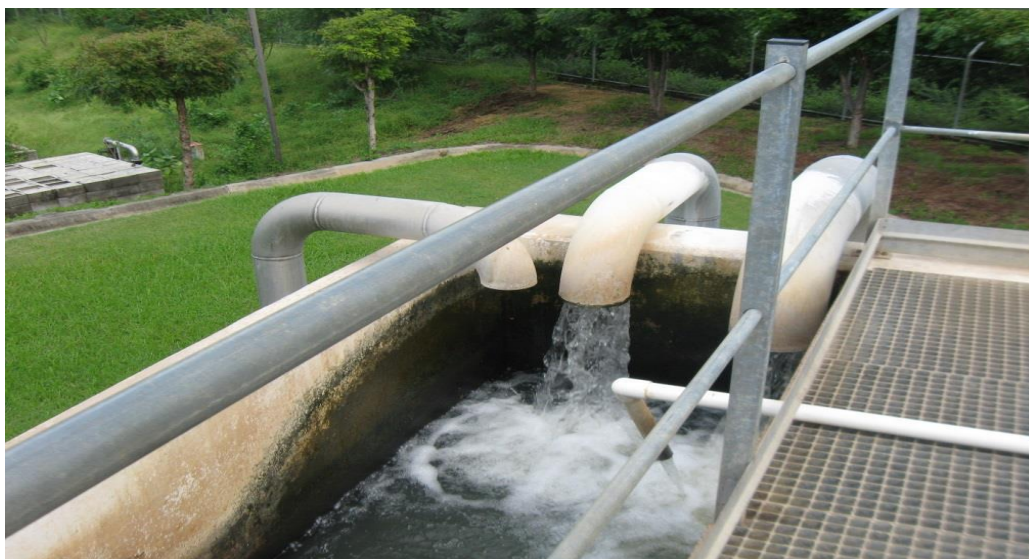
Figura 11. Entrada de agua a planta potabilizadora de Nacaome.
