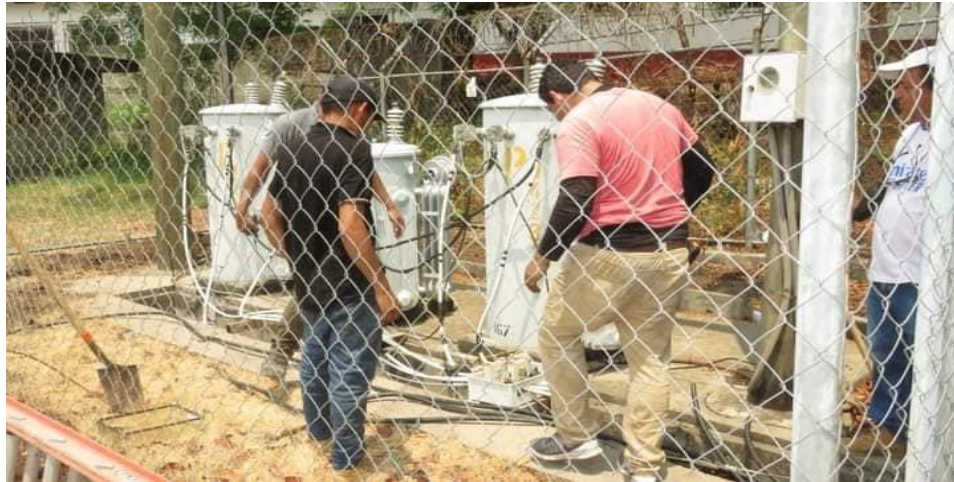
Figura 12. Transformadores de potencia eléctrica de planta potabilizadora de Nacaome.
