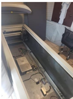
Ilustración 40. Revisión de densitómetro con falla leve.
