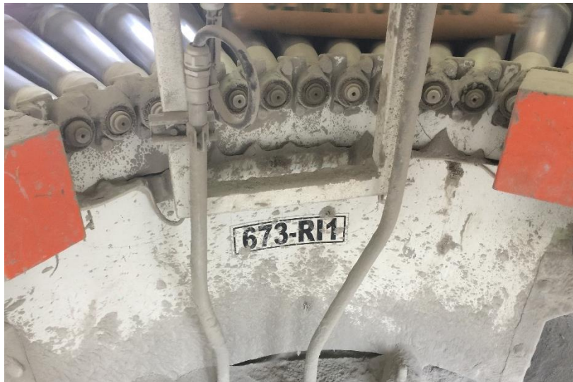
Ilustración 21. Exceso de Polvo en vía de rodillos.
