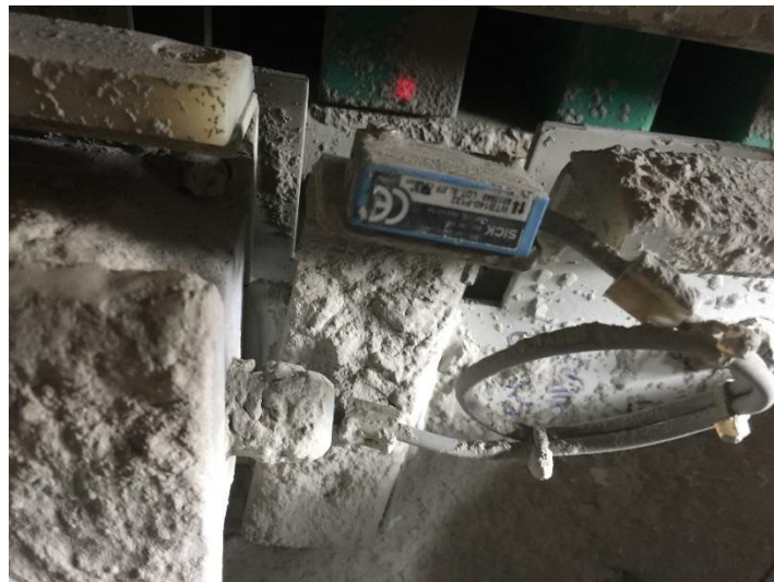
Ilustración 18. Falta de limpieza en fotocélula en Aplicador de Sacos INFILTO Z40.
