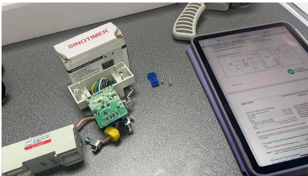
Ilustración 44 Mantenimiento Correctivo Capacitor
