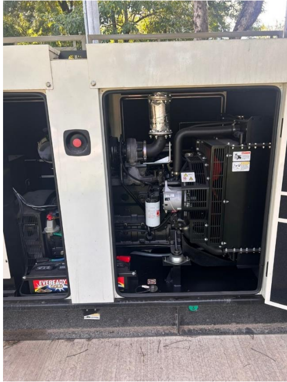
Anexo 73. Generador de Eléctrico Planta de Oxígeno
