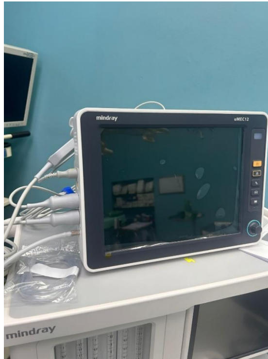
Anexo 53. Monitor de Signos Vitales Instalado
