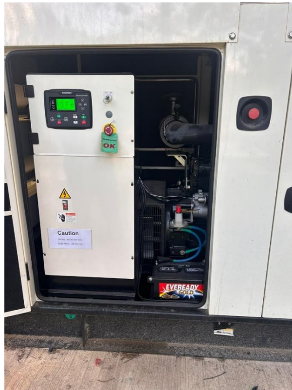
Anexo 72. Generador de Eléctrico Planta de Oxígeno
