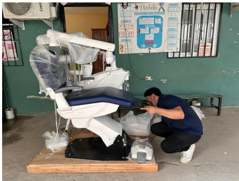
Anexo 62. Instalación de Unidad Odontológica
