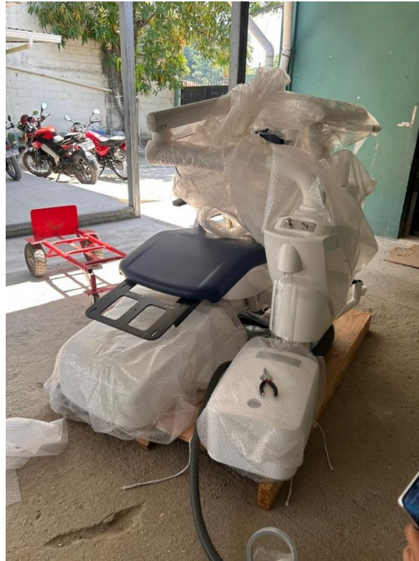
Anexo 61. Instalación de Unidad Odontológica
