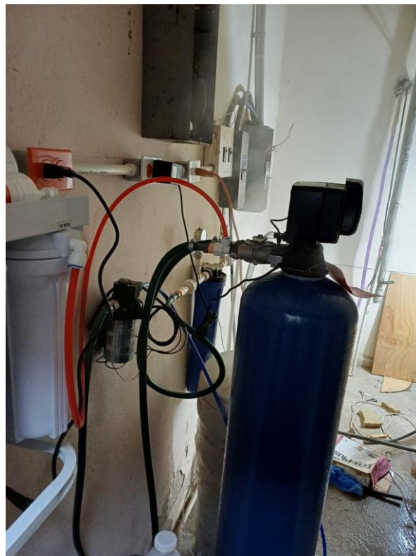
Anexo 32. Instalación de tratamiento de agua para Autoclave
