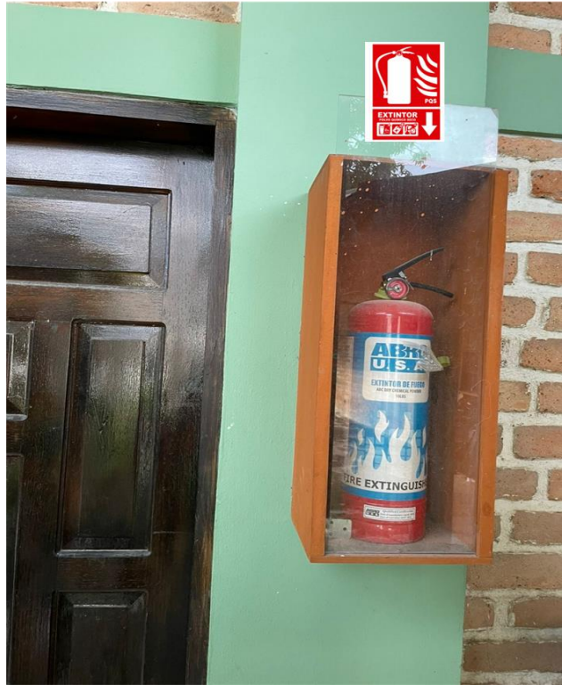
Ilustración 66 Señalización de extintor
