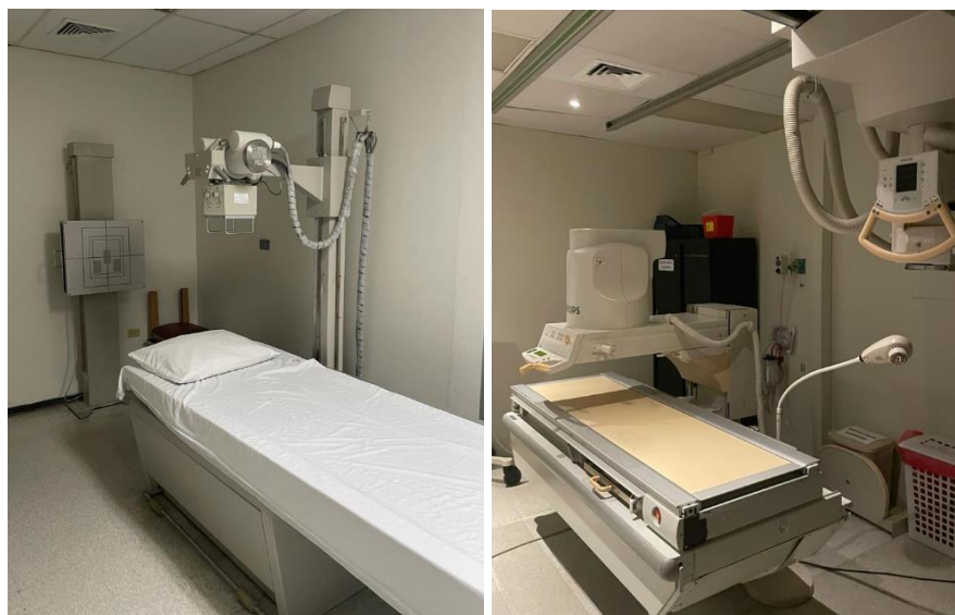
Ilustración 50: Equipos presentes en el área de imágenes del HDV
