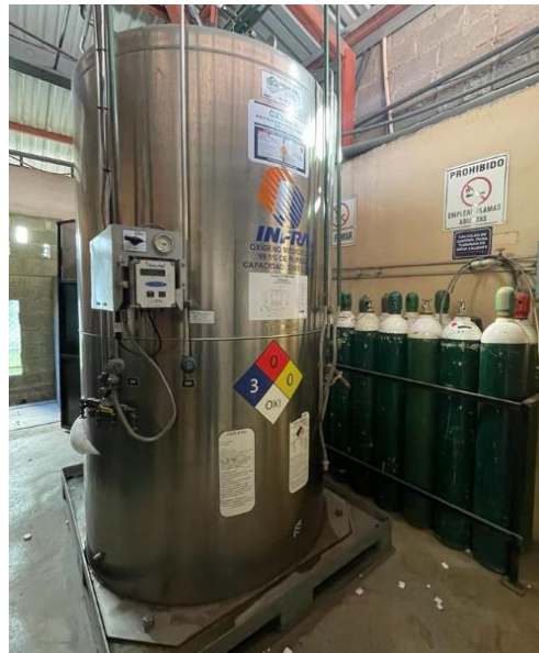
Anexo 13: Tanque criogénico de oxígeno en central de gases
