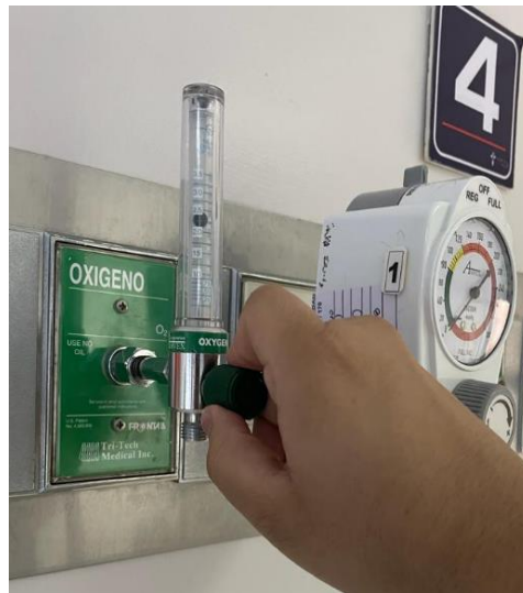
Ilustración 20: Mantenimiento preventivo a flujómetro
