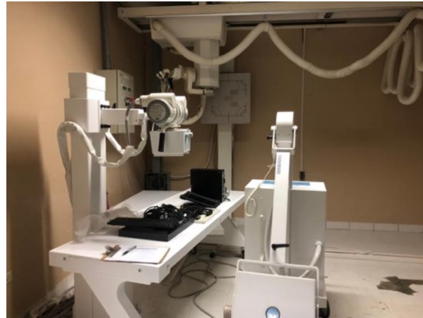
Ilustración 76. Sala 3 con equipos de rx
