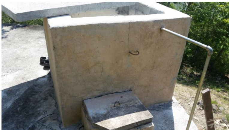
Ilustración 34. Grietas y fracturas en hipoclorador y caja de inspección
