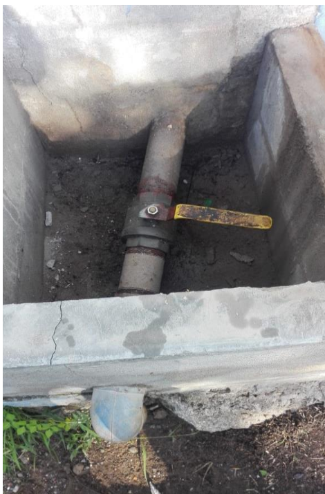
Ilustración 42. Válvula de salida del tanque de almacenamiento
