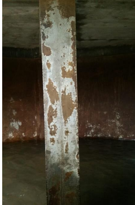
Ilustración 32. Desprendimiento de pintura en columna central
