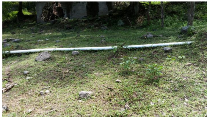
Ilustración 48. Tramo de PVC expuesto en línea de conducción
