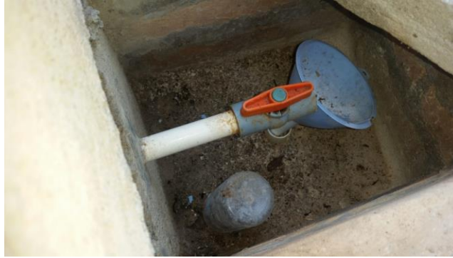
Ilustración 35. Filtro plástico quebrado y atascamiento por suciedad
