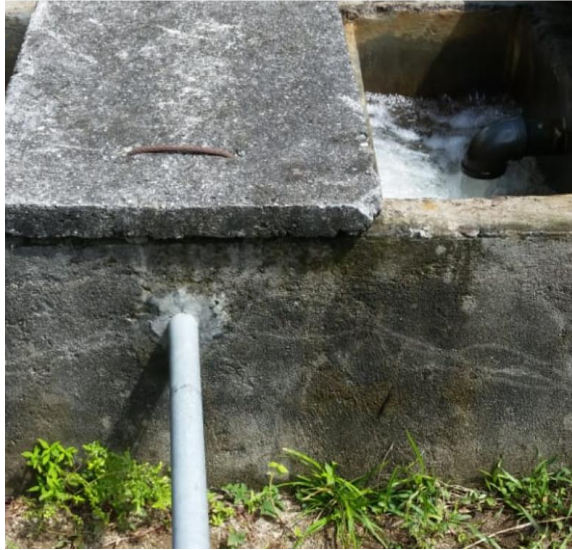
Ilustración 44. Capa de moho en cámara distribuidora
