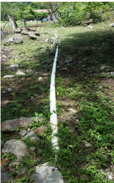
Ilustración 49. Tramo de PVC expuesto en línea de conducción
