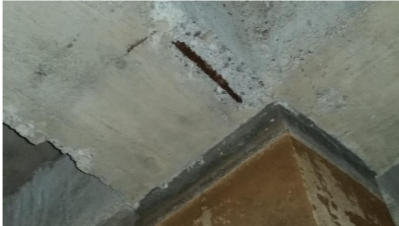
Ilustración 30. Vacío estructural en viga de carga
