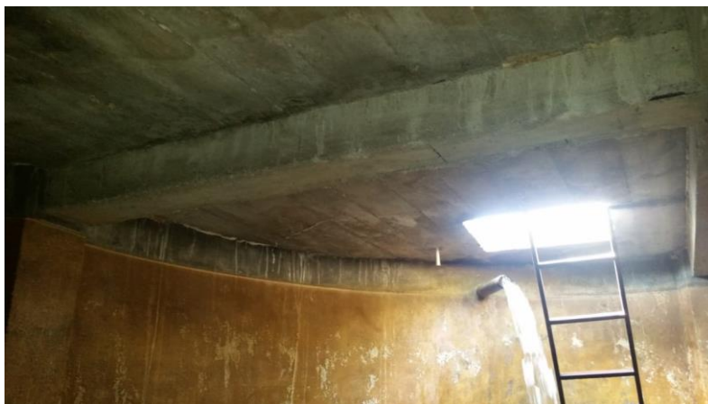
Ilustración 31. Exposición de acero de una viga de carga
