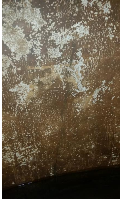
Ilustración 28. Recubrimiento del contorno dañado
