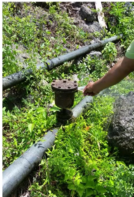
Ilustración 47. Válvula expulsora de aire con fugas
