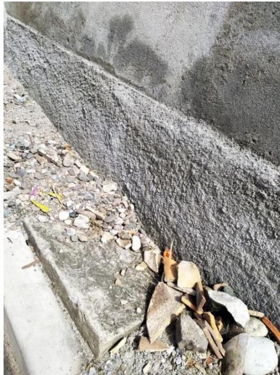
Ilustración 40. Caja de registro de nodo 2 hundida bajo muro perimetral
