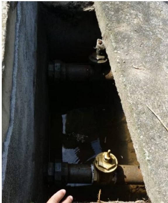
Ilustración 45. Válvulas de salida en cámara distribuidora
