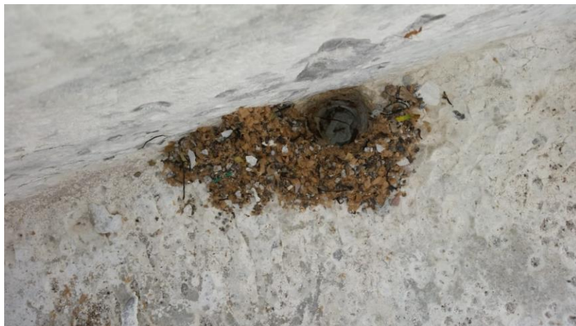
Ilustración 33. Plaga de insectos y suciedad en hipoclorador
