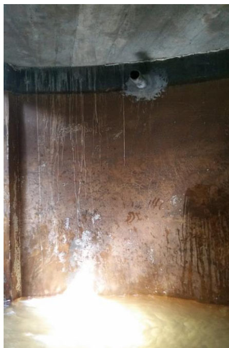
Ilustración 29. Daño en pintura de paredes
