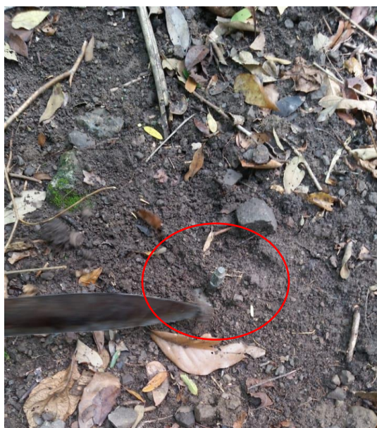
Ilustración 46. Válvula de compuerta sin mariposa ni caja protectora
