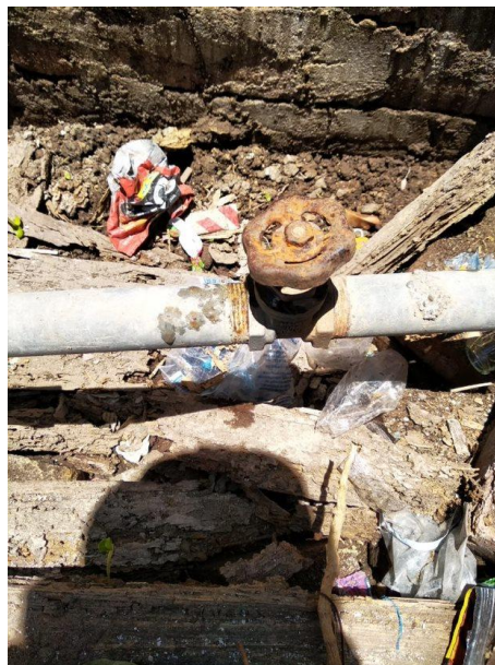
Ilustración 36. Fuga detectada y escombros alrededor de válvula de compuerta
