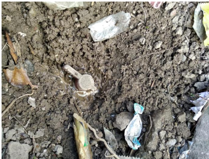
Ilustración 37. Fuga en válvula de conexión domiciliar
