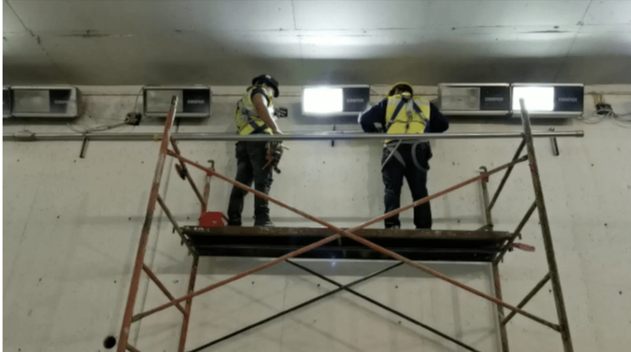
Ilustración 63 - Mantenimiento de las luminarias de un túnel
