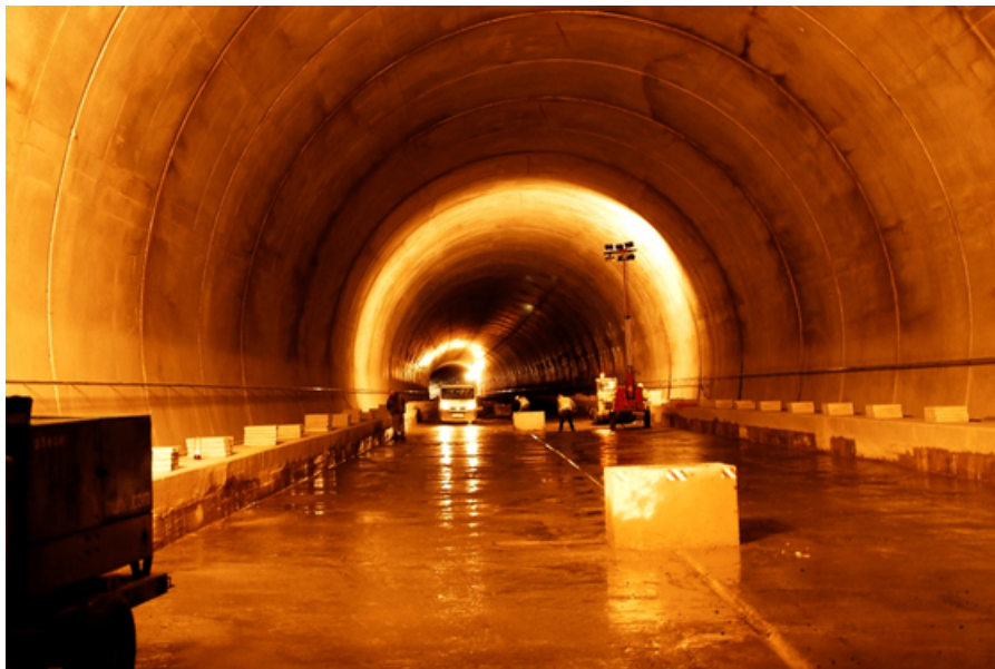
Ilustración 62- Ejemplo de un mal drenaje interno en un túnel semicircular
