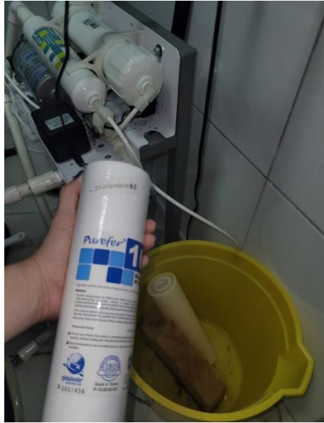
Ilustración 35: Cambio de filtro de sistema de osmosis
