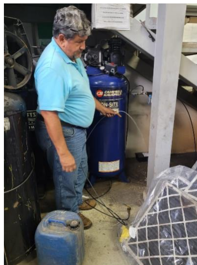
Ilustración 17: Drenaje de compresor
