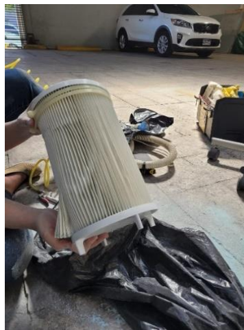
Ilustración 27: Cambio de filtro de sistema de extracción de yeso
