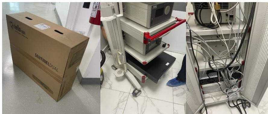
Ilustración 47- Instalación de UPS para torre de laparoscopia en sala de operaciones.
