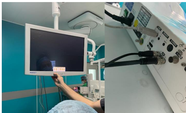
Ilustración 60- Colocación de cable BNC en torre de laparoscopia.
