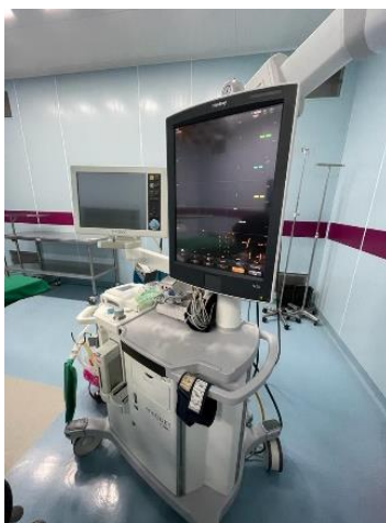
Ilustración 69- MSV con falla en toma de presión no invasiva y con ruido no comun.
