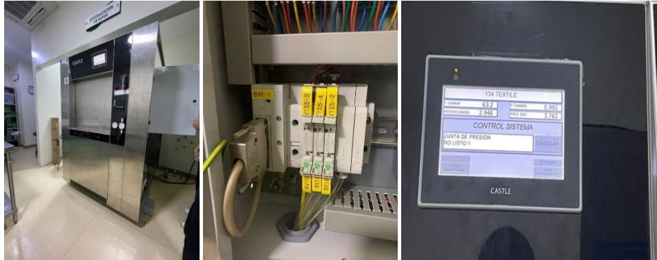
Ilustración 25- Autoclave Castle Smart-S 555 con problemas en el inicio del proceso de esterilización.
