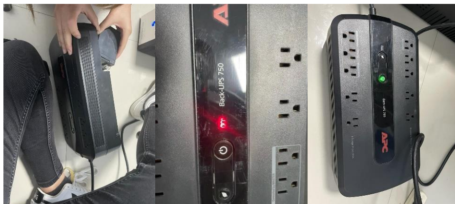
Ilustración 72- Revisión de UPS de laboratorio clínico.
