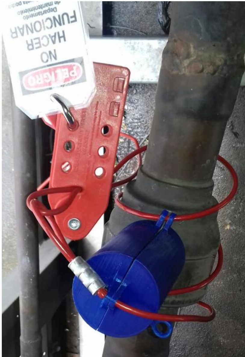
Anexo 12. Guardas de seguridad ubicada en el área.
