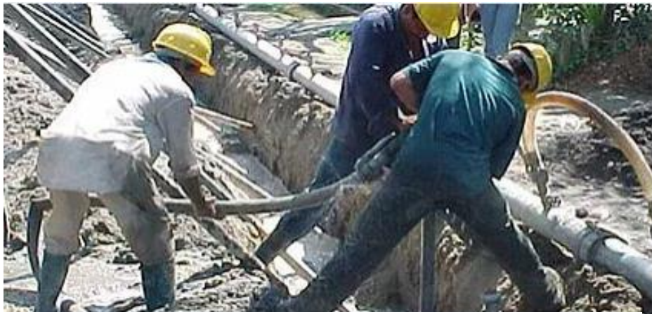
Ilustración 4. Sistema de Pozos Punta utilizados en Puerto Cortés, Cortés
