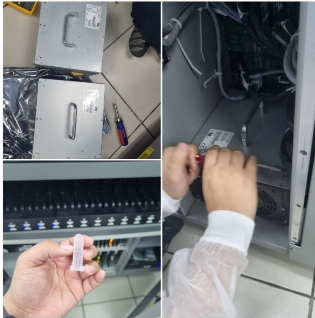
Ilustración 42 - Prueba de Fuente nueva en i10000SR en HDC.
