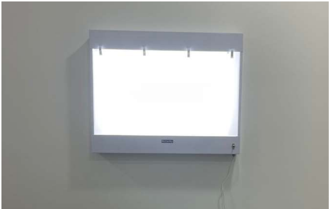
Ilustración 43 Negatoscopio instalado en sala de ortopedia
