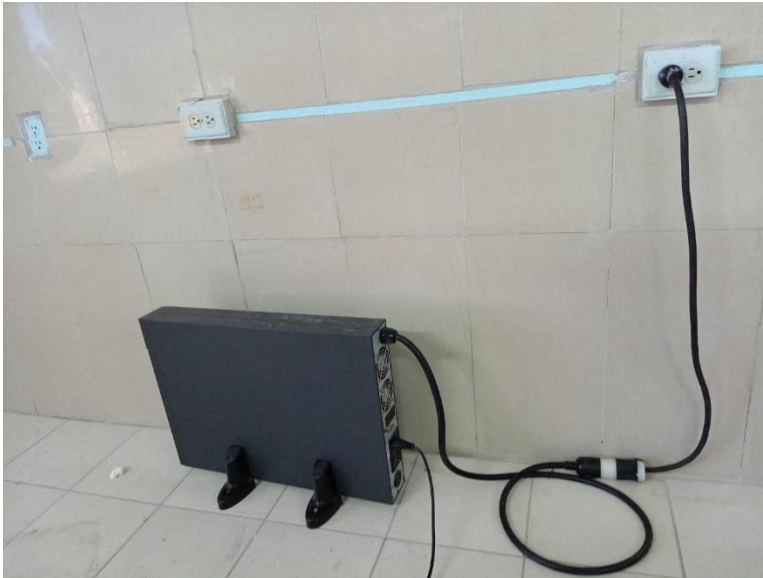
Ilustración 23. UPS Sala de neonatos
