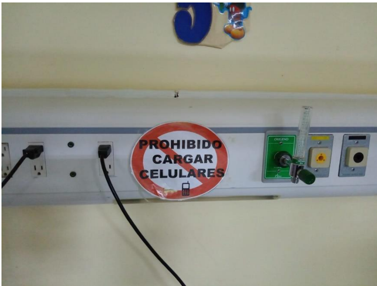
Ilustración 28. Toma de gases de Emergencia Pediátrica
