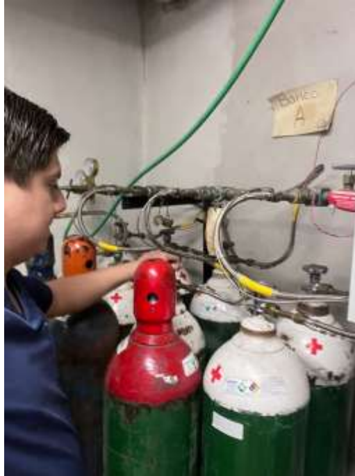
Ilustración 62- Cambio de cilindros de oxígeno
