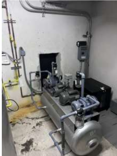
Ilustración 58- Compresor de vacío
