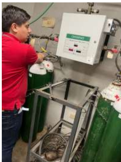
Ilustración 49- Inspección de oxígeno en manifold
