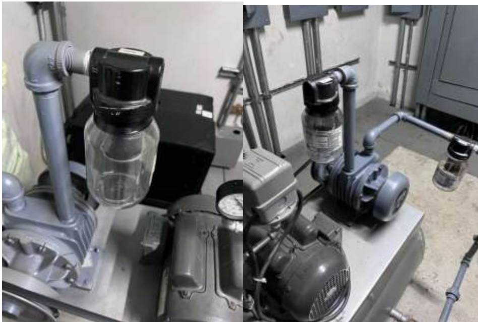
Ilustración 63- Compresor de Vacío
