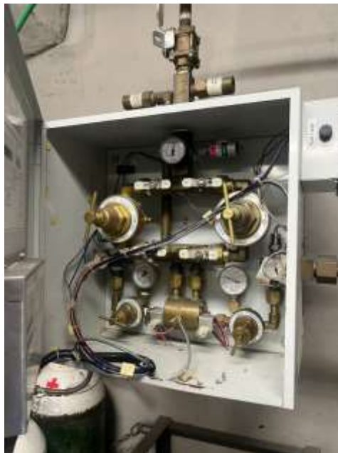
Ilustración 33- Panel de control manifold
