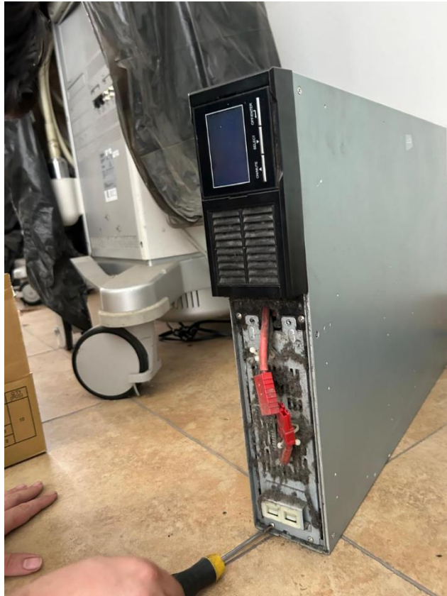
Anexo 6: Limpieza interna de UPS
