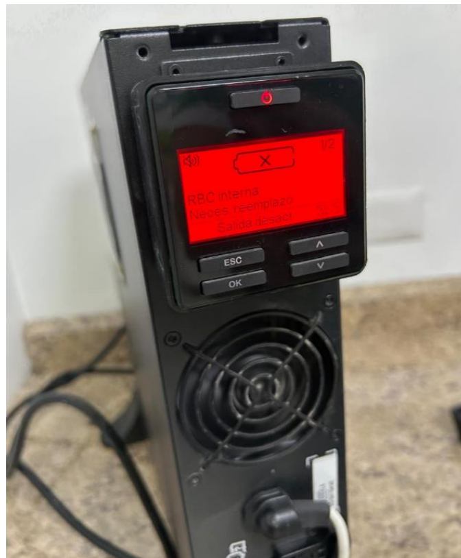
Ilustración 42: Cambio de baterías de UPS
