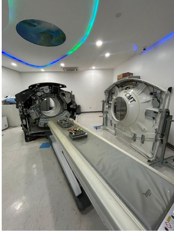
Anexo 7: Reparación de PET-CT
