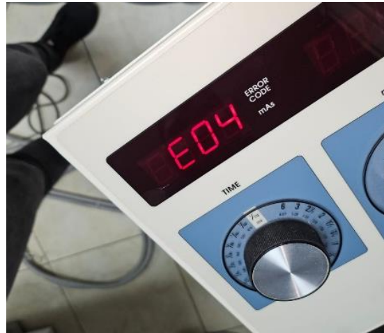
Ilustración 48 - Error presentado por un falso contacto en los cables de conexión
