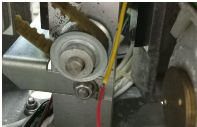
Ilustración 24 - Desprovisto de revestimiento aislante en cable
