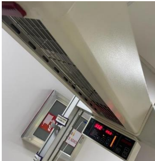
Ilustración 43 - Cuna térmica con switch instalado
