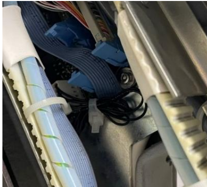
Ilustración 26 - Colocación de la fajilla al cable para evitar el falso contacto
