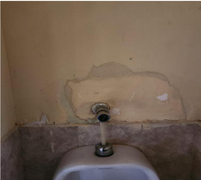
Figura 25 . Paredes y urinarios dañados. Fuente: (Elaboración propia, 2025).
