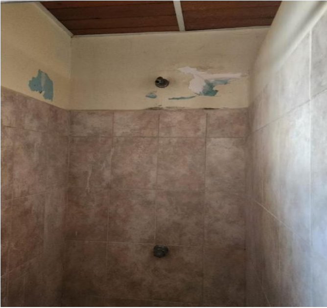
Figura 26 . Duchas dañadas. Fuente: (Elaboración propia, 2025).
