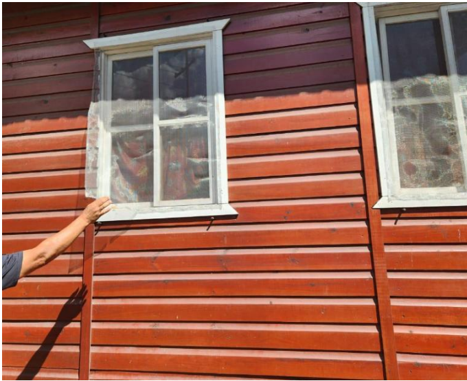
Figura 27 . Daños en ventanas. Fuente: (Elaboración propia, 2025).
