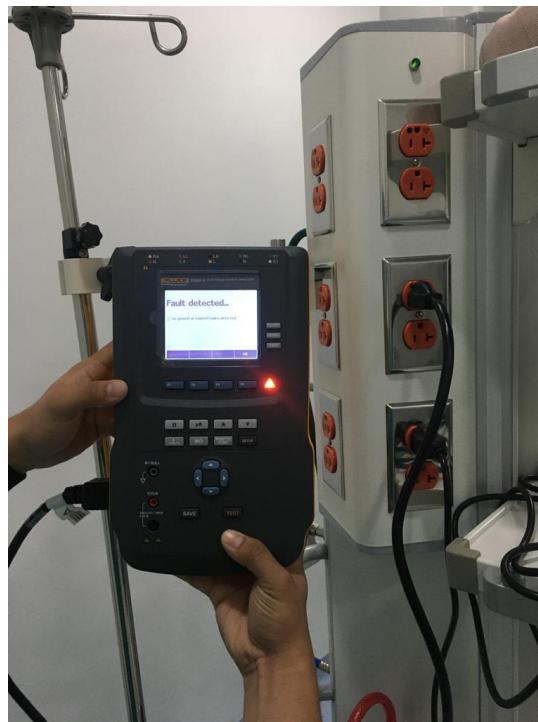
Ilustración 35-Analizador de seguridad Eléctrica detectando que, no sé encuentra la conexión a tierra en los receptáculos.
