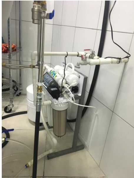
Ilustración 26-Sistema de Ósmosis para Autoclave
