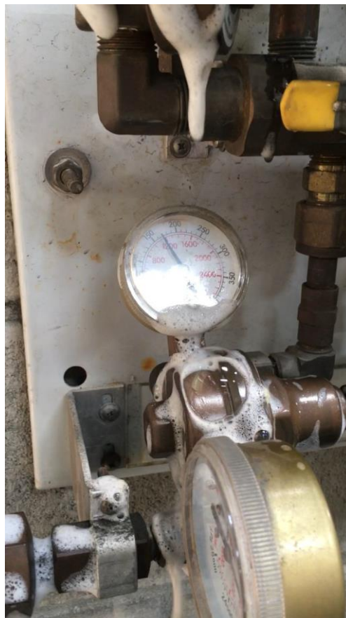
Ilustración 44-Fuga detectada en el regulador izquierdo del manifold
