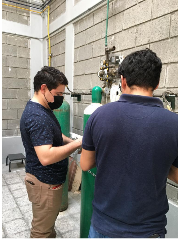
Ilustración 45-Visita técnica de revisión de estado del manifold por parte de Dimex
