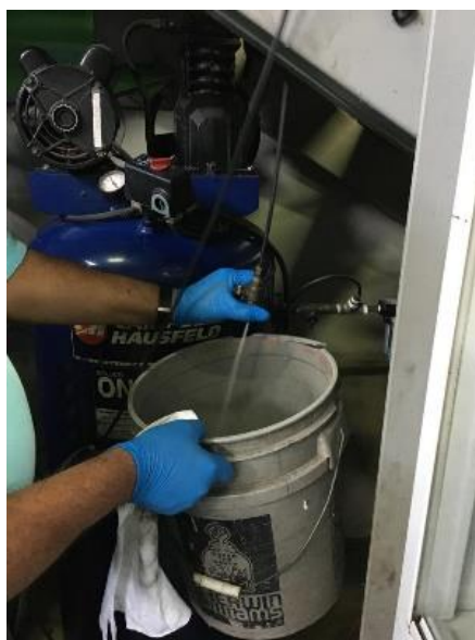
Ilustración 28-Mantenimiento Preventivo a los Compresores por Inversiones Asamma Group
