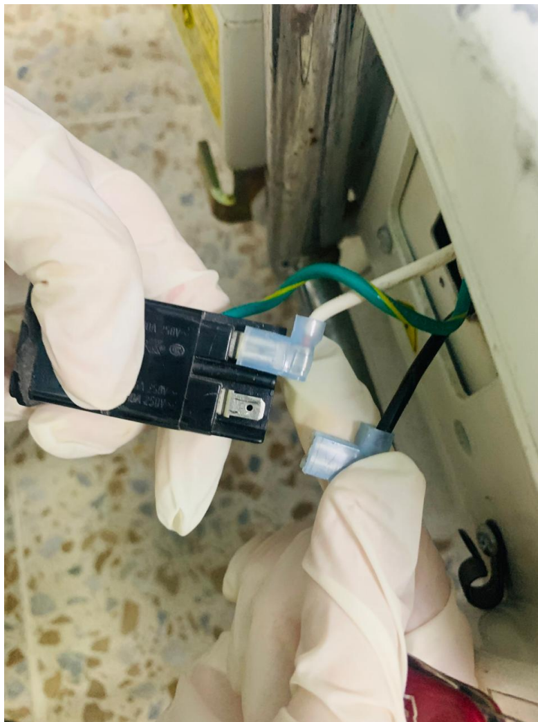
Ilustración 47. Terminal de alimentación de cama eléctrica en mal estado
