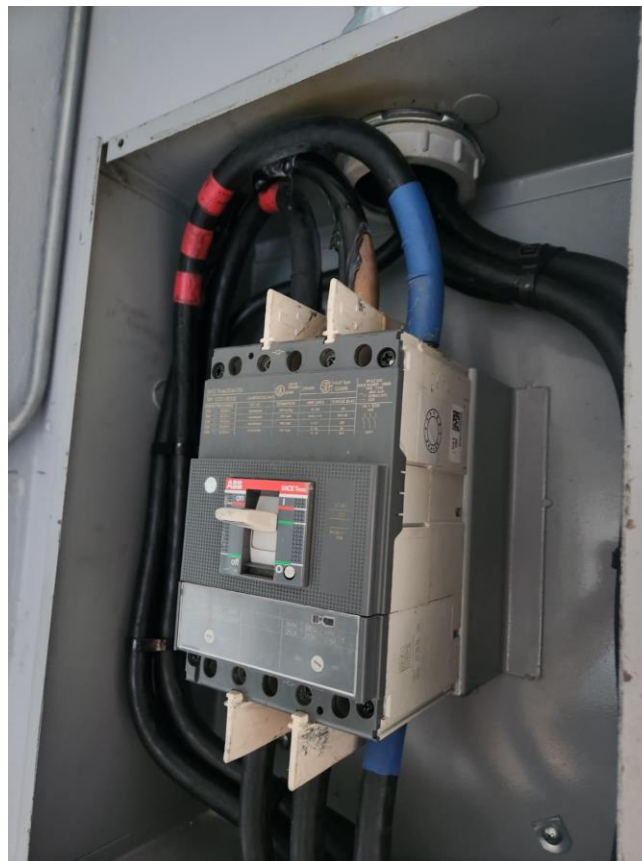
Ilustración 61. Panel de suministro eléctrico de planta de oxígeno.
