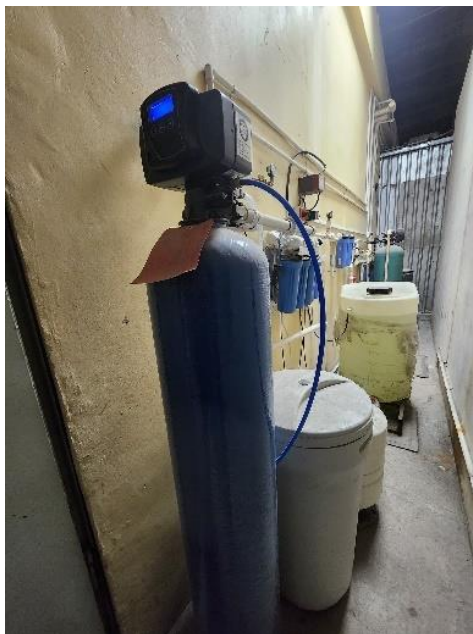
Ilustración 10. Tanque de resina con controlador instalado.
