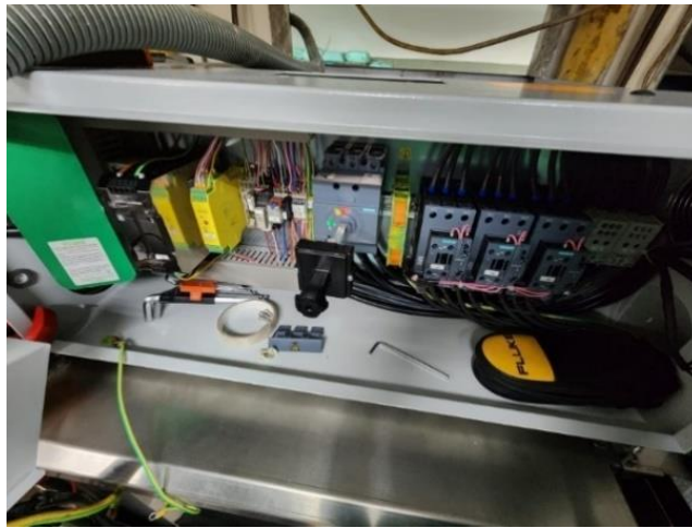
Ilustración 33. Panel eléctrico principal de autoclave.
