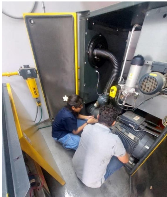
Ilustración 51. Mantenimiento a compresor de planta de oxígeno.
