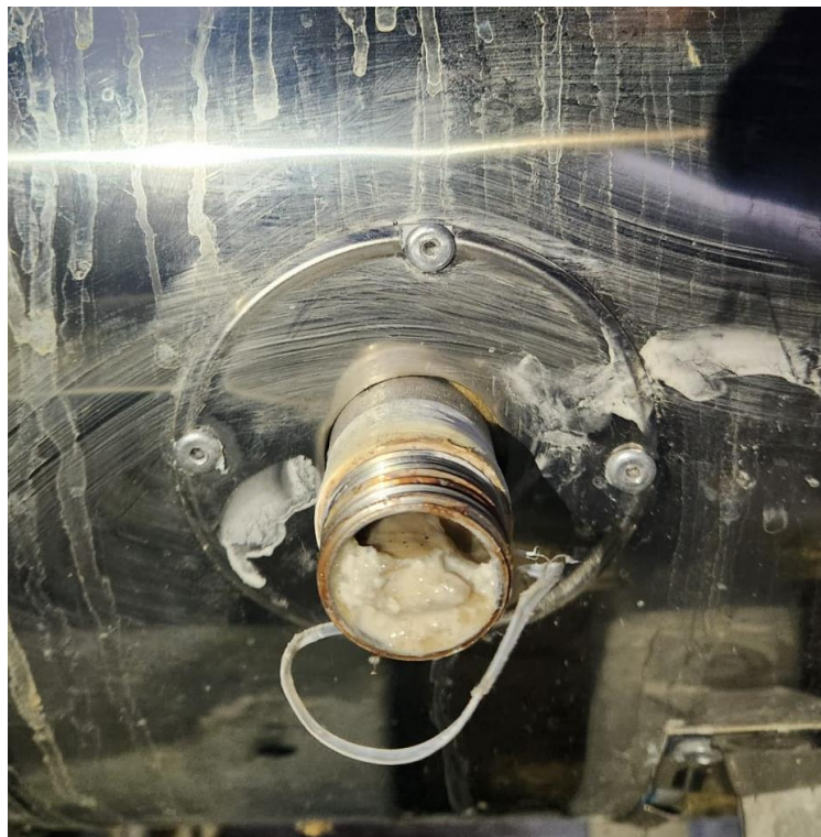
Ilustración 43. Obstrucción encontrada en salida de agua de la cámara generadora de vapor.
