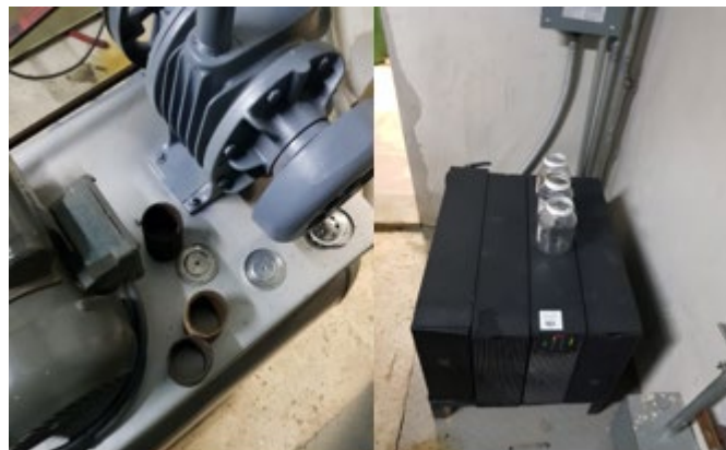
Ilustración 14 - Limpieza de filtros del compresor de vacío de aire
