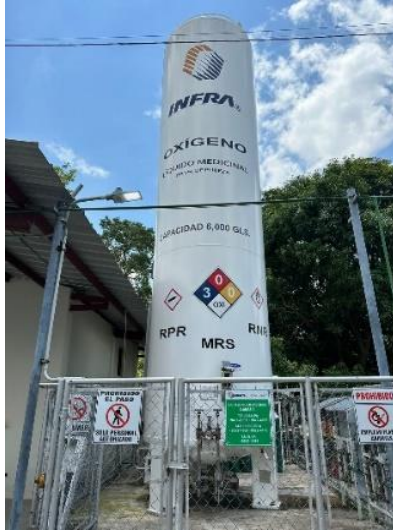
Ilustración 10 Tanque criogénico del HMCR.
