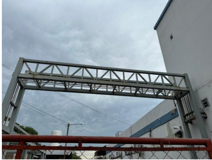
Ilustración 9 Soportería de las tuberías.
