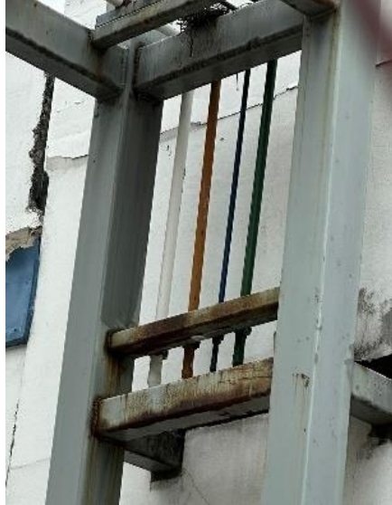
Ilustración 8 Identificación de tuberías de gases medicinales.
