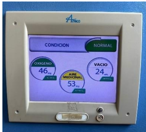
Ilustración 6 Panel de alarma local de gases medicinales.
