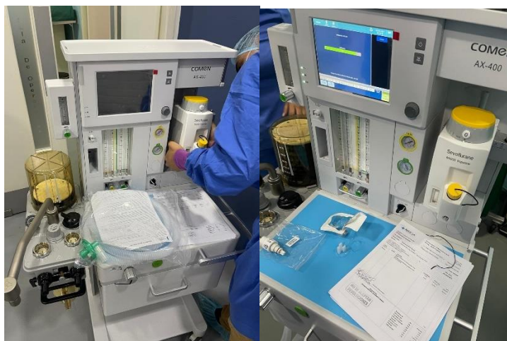
Ilustración 65 Instalación Máquina de Anestesia
