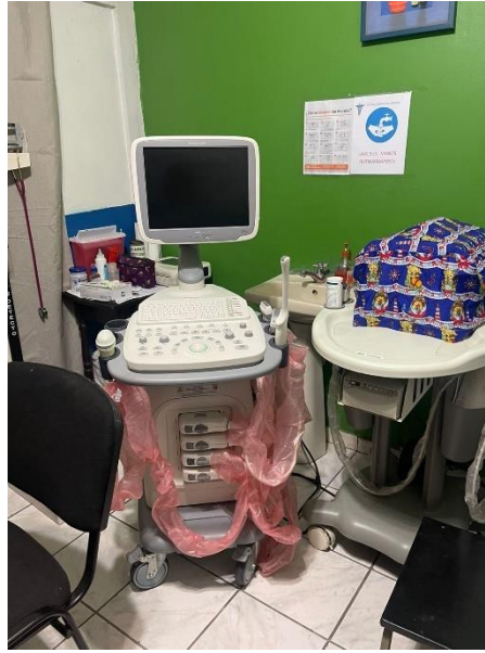
Ilustración 46 Instalación de Ultrasonido
