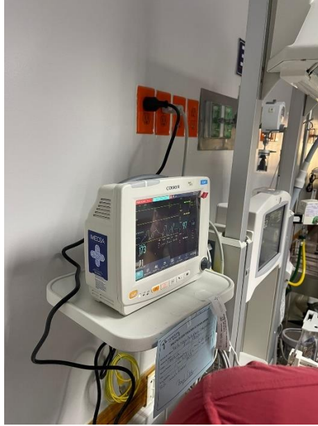
Ilustración 45 Instalación de MSV Neonatal
