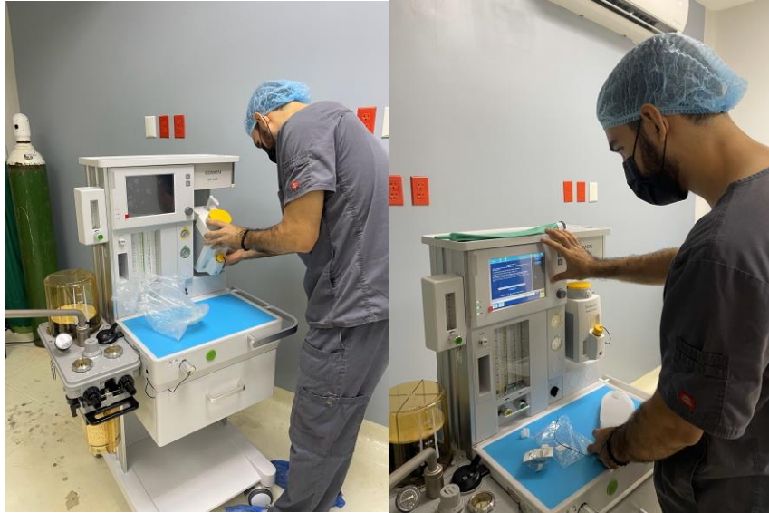
Ilustración 25 Instalación de Máquina de Anestesia
